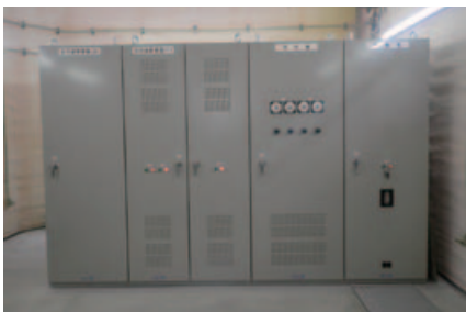
高圧キュービクル
