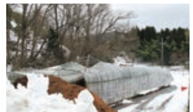
倒壊したビニールハウス
