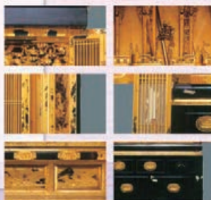
修復前の破損や汚れ
