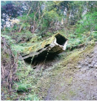
地震により崩落した導水路
