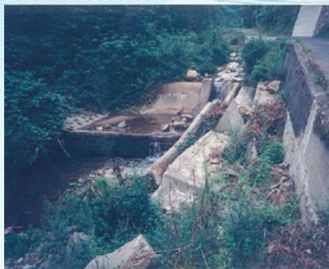
濁流で破壊された取水口
