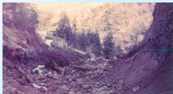
土石流で破壊された水路橋
